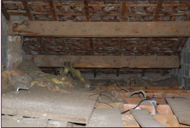
Absence d'isolation en toiture
