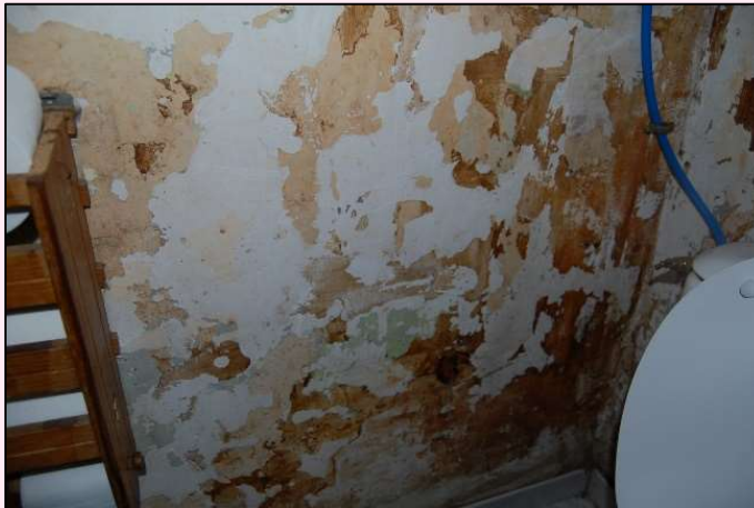
Revêtements de mur en mauvais état
