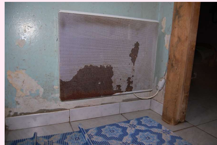
Radiateur électrique obsolète
